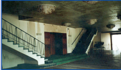
Zugang zum Großen Saal im 1. Foyer nach dem Brand.
