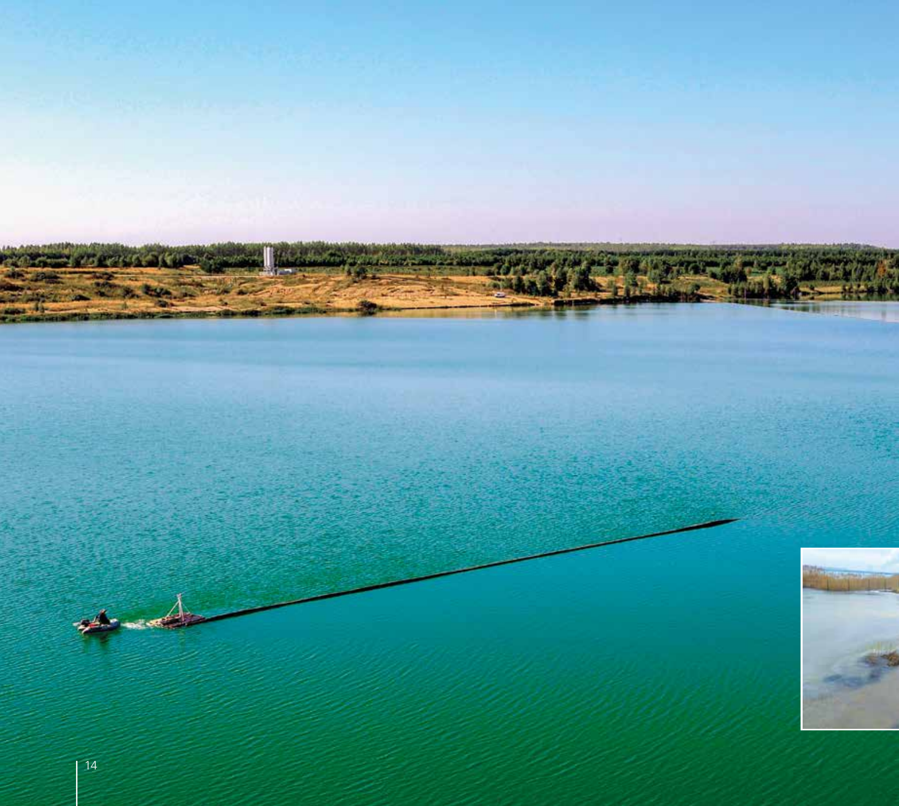
Anlage zur Neutralisation des Hainer Sees, 2008
