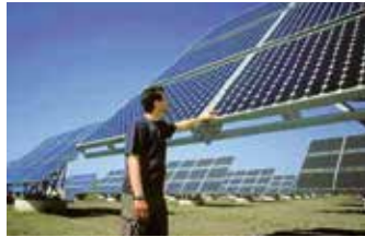
Kontrolle der Photovoltaikmodule im Solarpark Borna, 2006
