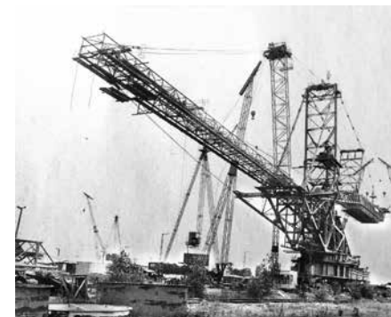
Absetzer A fs-B 10.000-1124 kurz vor der Endmontage auf dem Montageplatz „Käferhain“ im Tagebau Groitzscher Dreieck, 1984 Montageplatz für Bandanlagen im Groitzscher Dreieck, 1965
