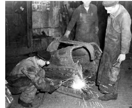
Schweißarbeiten zur Reparatur eines Eimers für einen Bagger im Tagebau Zwenkau, 1960 Instandhaltungsarbeiten an einem Getriebe, 1960
