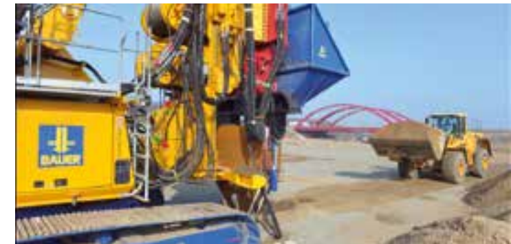
Rüttelstopfverdichtung auf der Trasse des Harthkanals, 2015 Baustelle des Harthkanals im Süden des Cospudener Sees, 2015
