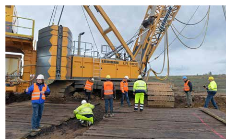
Nur als Gemeinschaftswerk erfolgreich: Eine Vielzahl von beteiligten Mitarbeitern von Behörden, auftragnehmenden Firmen und LMBV arbeiten zusammen.
