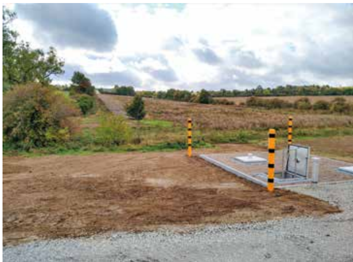
Schachtbauwerk an der Laugenleitung bei Menteroda
