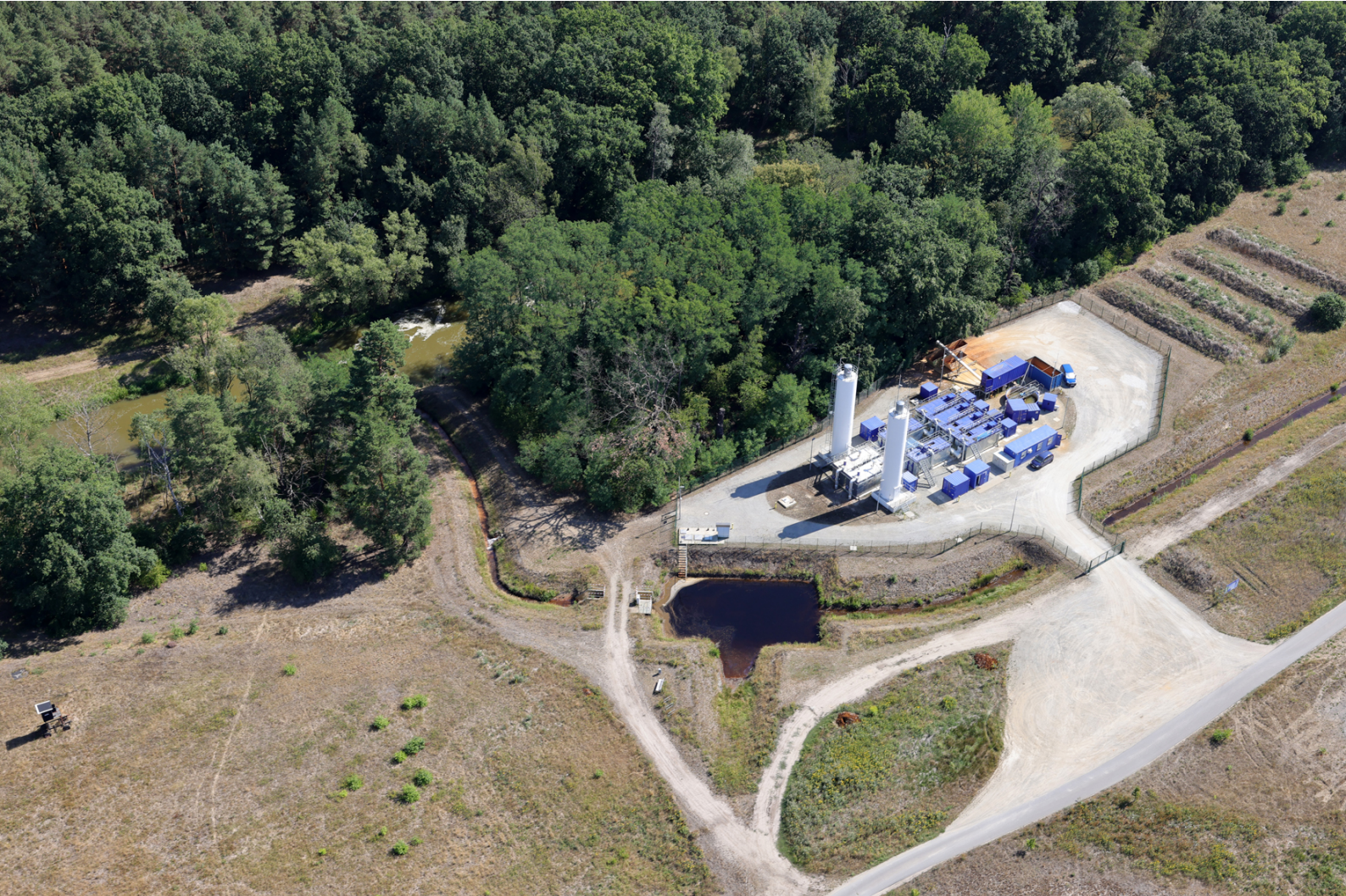
Modulare Wasserbehandlungsanlage (MWBA) Neustadt der LMBV
