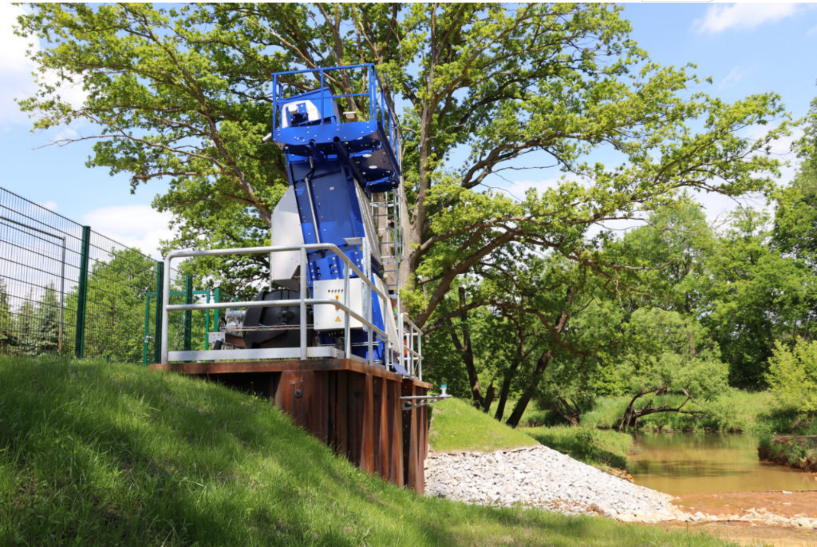
Automatische Rechenreinigungsanlage fängt Schwemmgut vor der Pumpstation der MWBA ab
