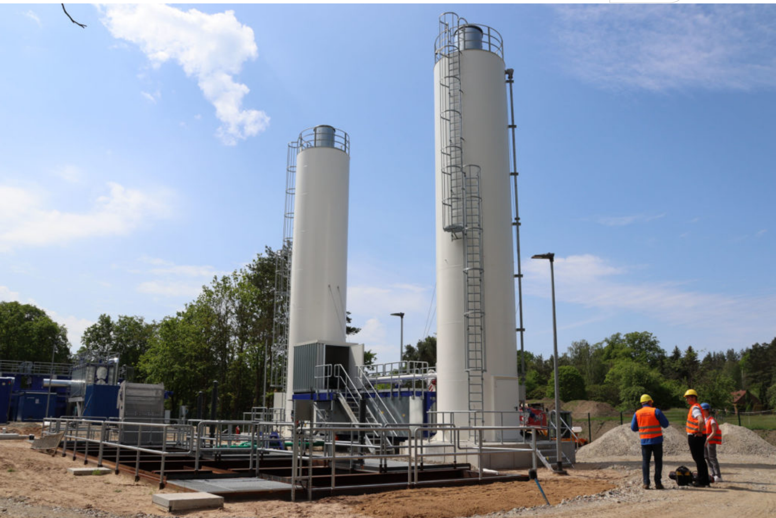
Kalksilos, Reaktionscontainer und -becken der MWBA Ruhlmühle
