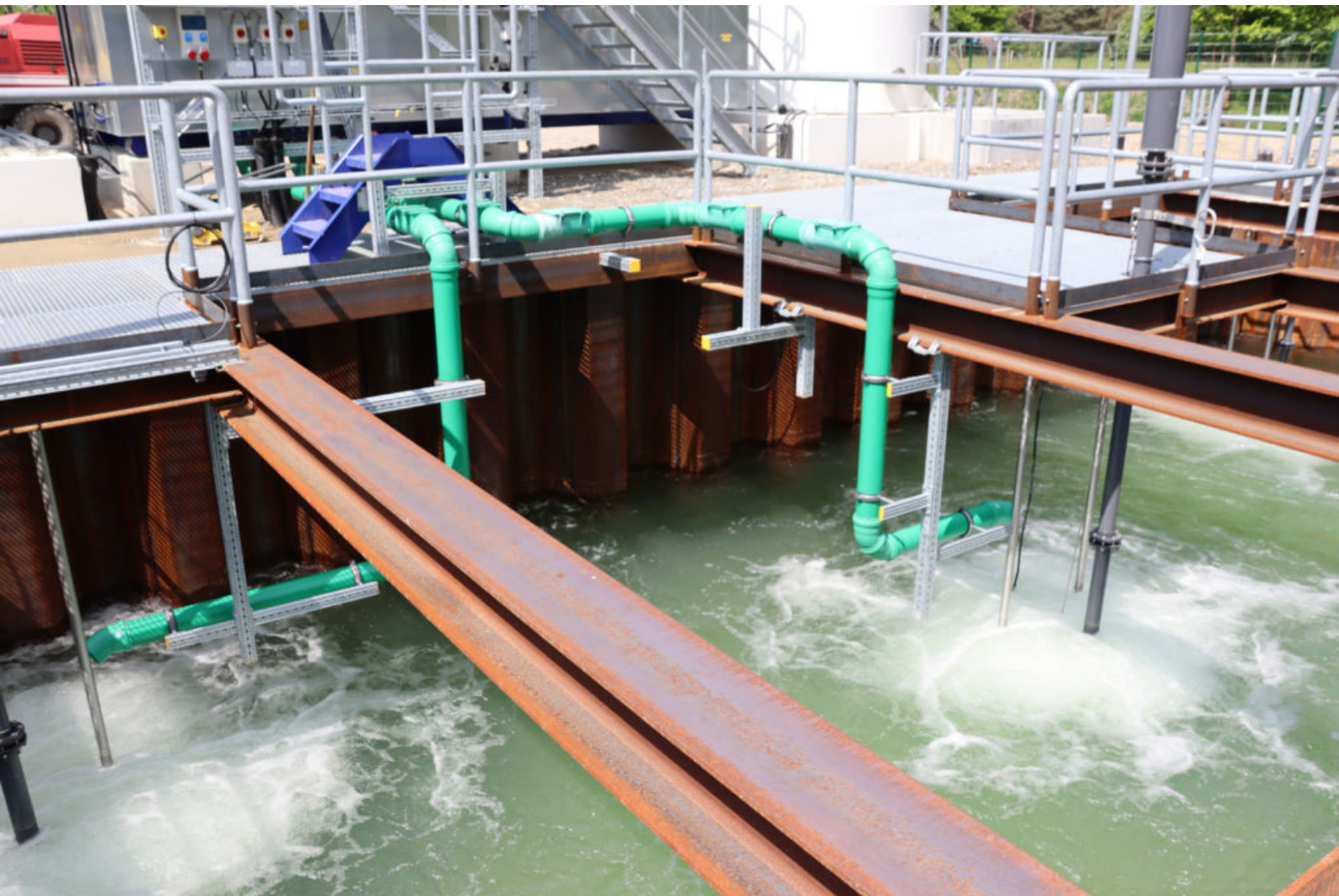
Inbetriebnahme des Reaktionsbeckens
