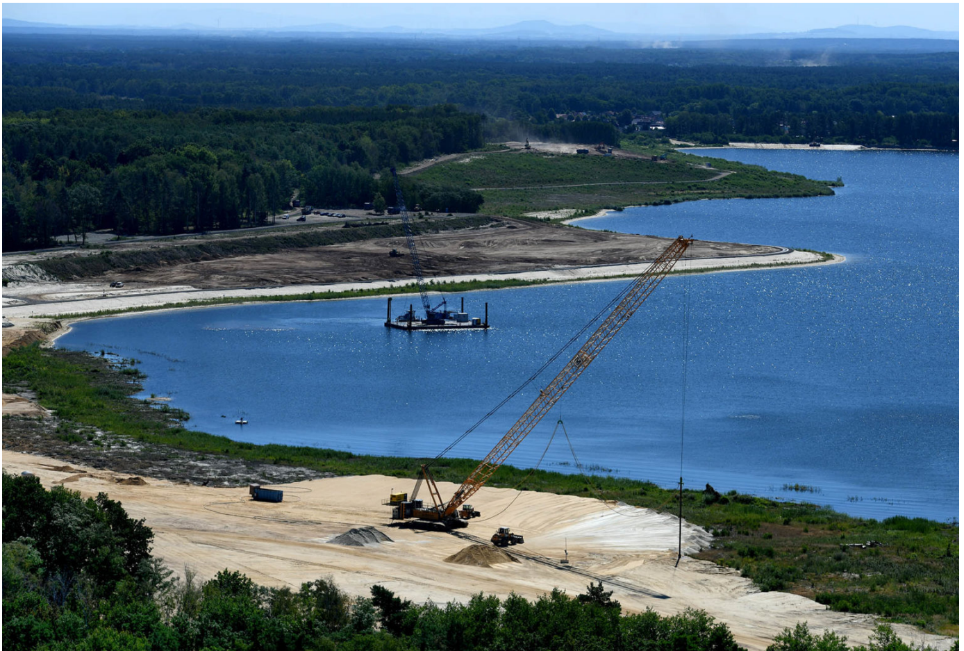
Landseitige und seeseitige RDV-Technik am Knappensee
