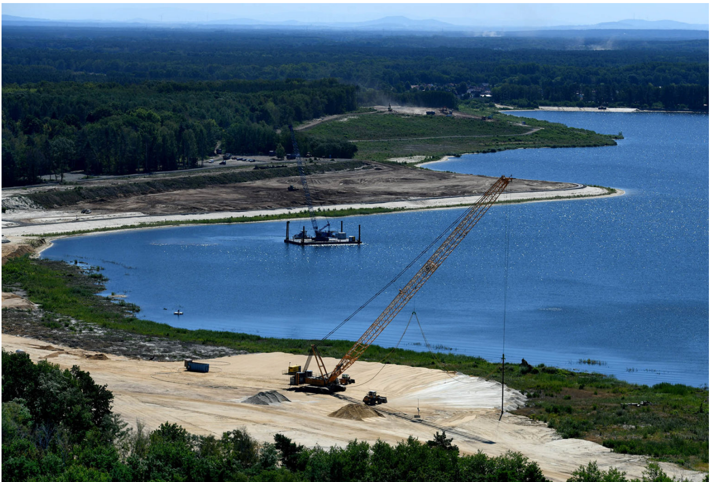
Landseitige und seeseitige RDV-Technik am Knappensee
