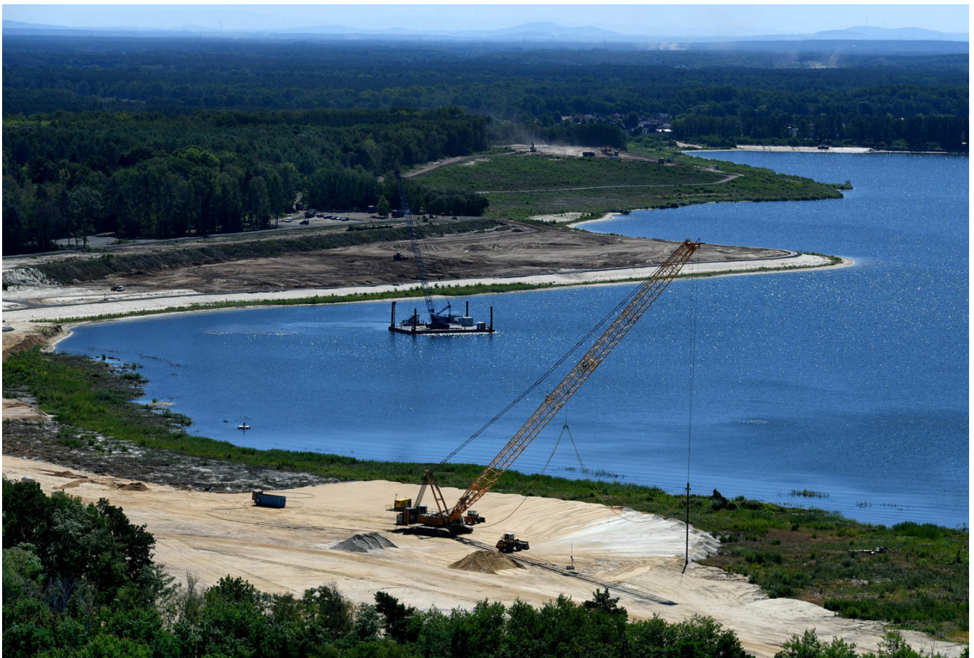
Landseitige und seeseitige RDV-Technik am Knappensee
