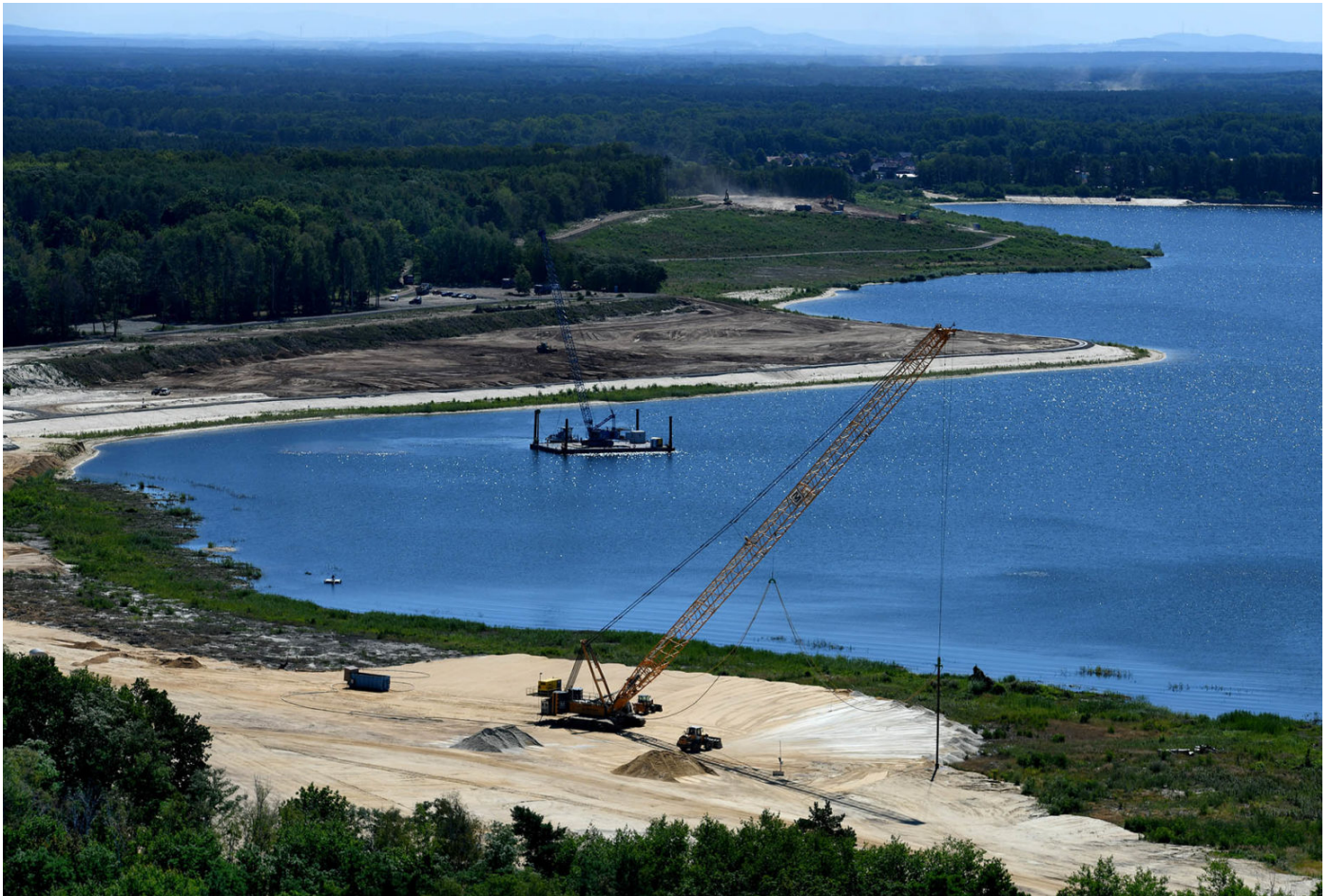
Landseitige und seeseitige RDV-Technik am Knappensee
