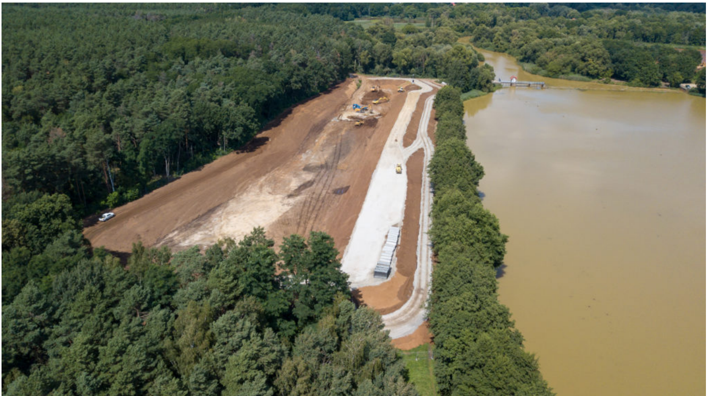
Sedimentationsbecken III an der Vorsperre Bühlow / Fotos: Steffen Rasche und Christian Horn
