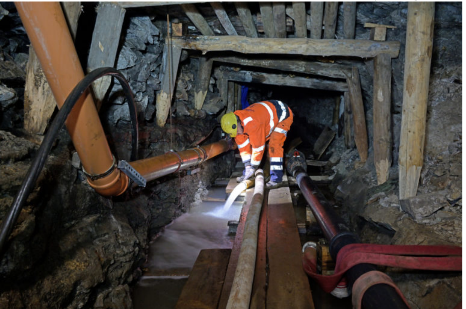
Das überschüssige Wasser wird über ein Pumpensystem in den Seegen-Gottes-Stolln gehoben.
