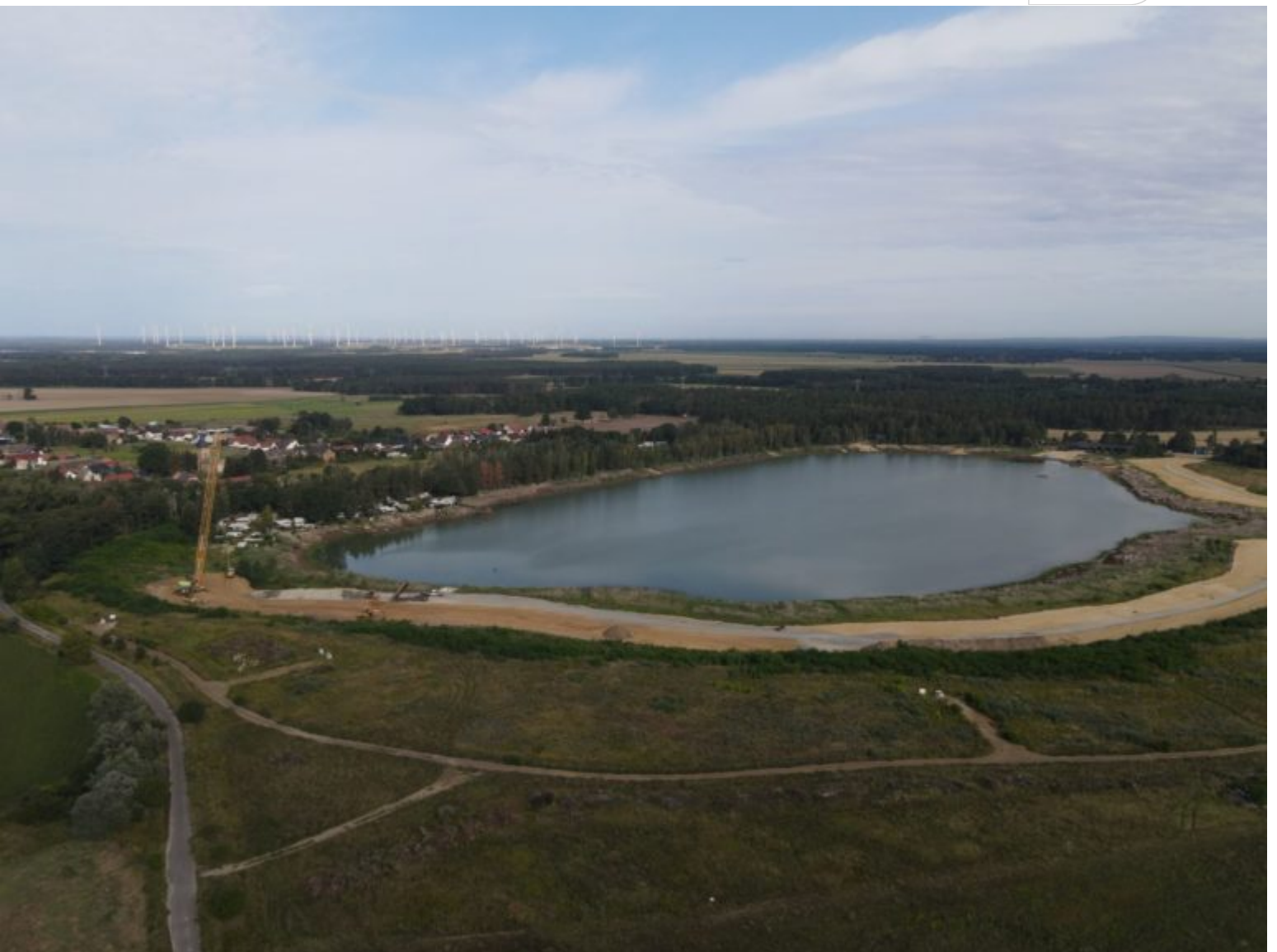
Blick von West nach Osten über den in Sanierung befindlichen Hindenberger See
