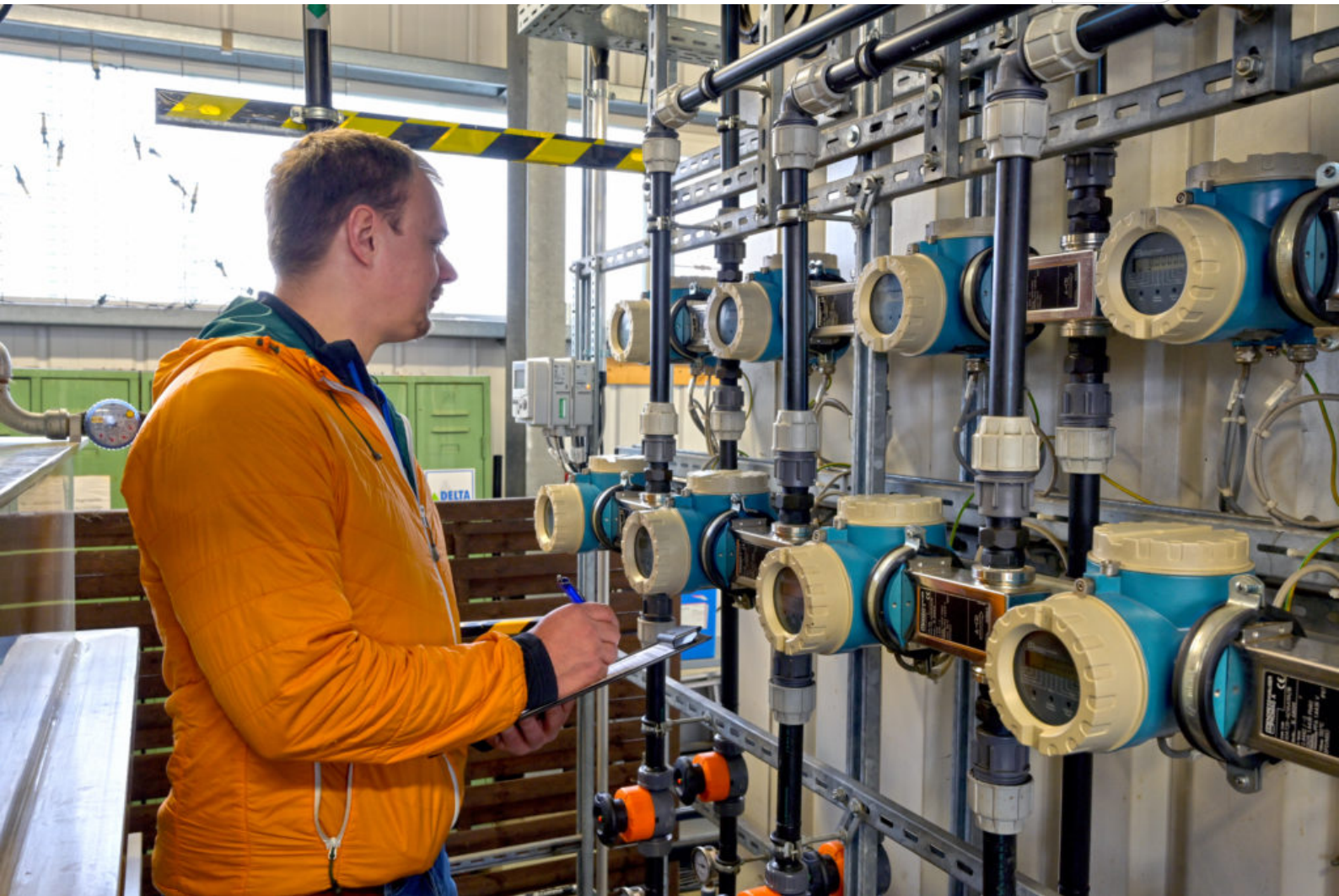
Dokumentation von Messwerten in der Grundwasserreinigungsanlage Zwickau/Schedewitz
