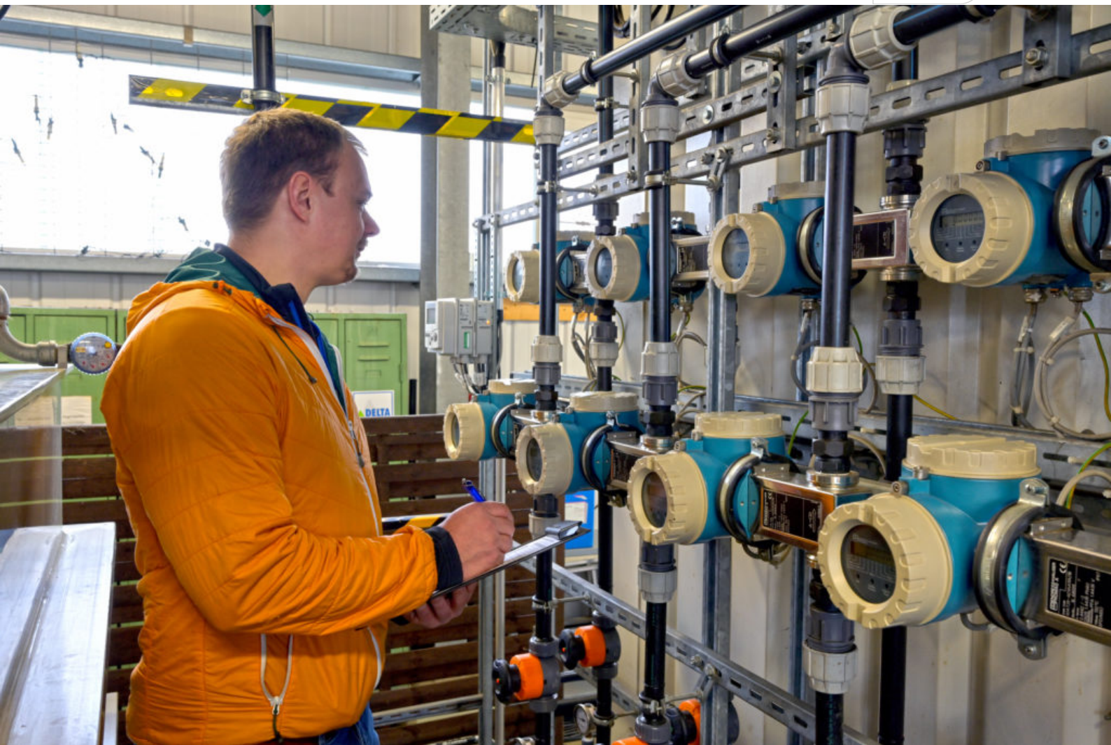
Dokumentation von Messwerten in der Grundwasserreinigungsanlage Zwickau/Schedewitz
