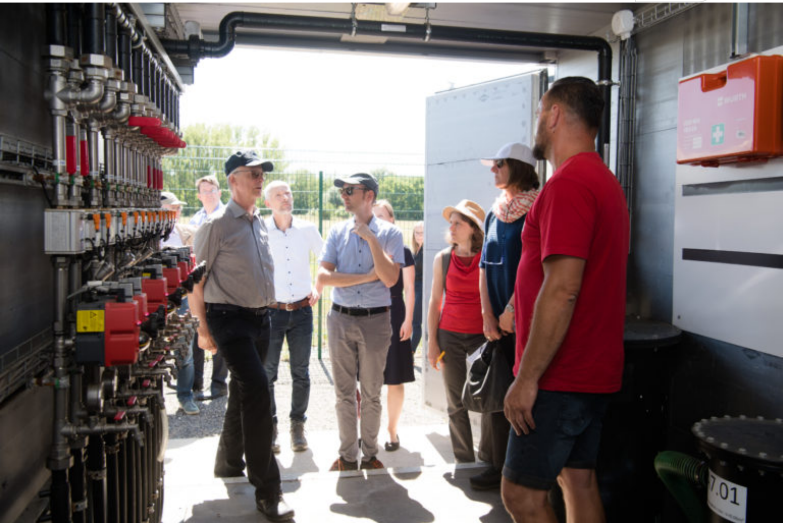
Fachaustausch zur Funktionsweise der Anlage.
