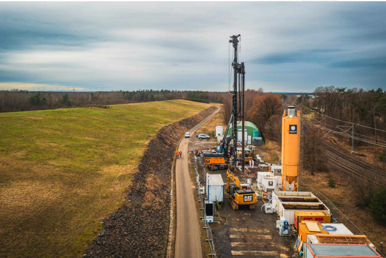
Baustelleneinrichtung an der APH Terpe (Foto: Gernot Menzel) Fotos: LMBV / Uwe Steinhuber
