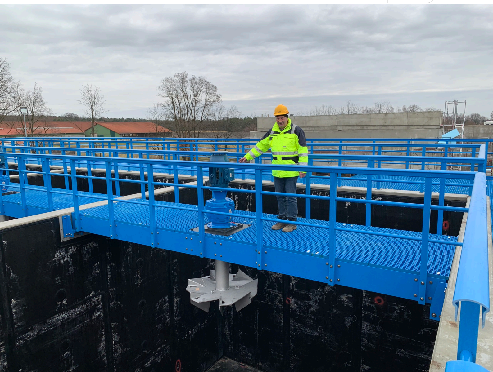
LMBV-Projektmanager Andreas Meth am installierten Motor eines Rührwerks
