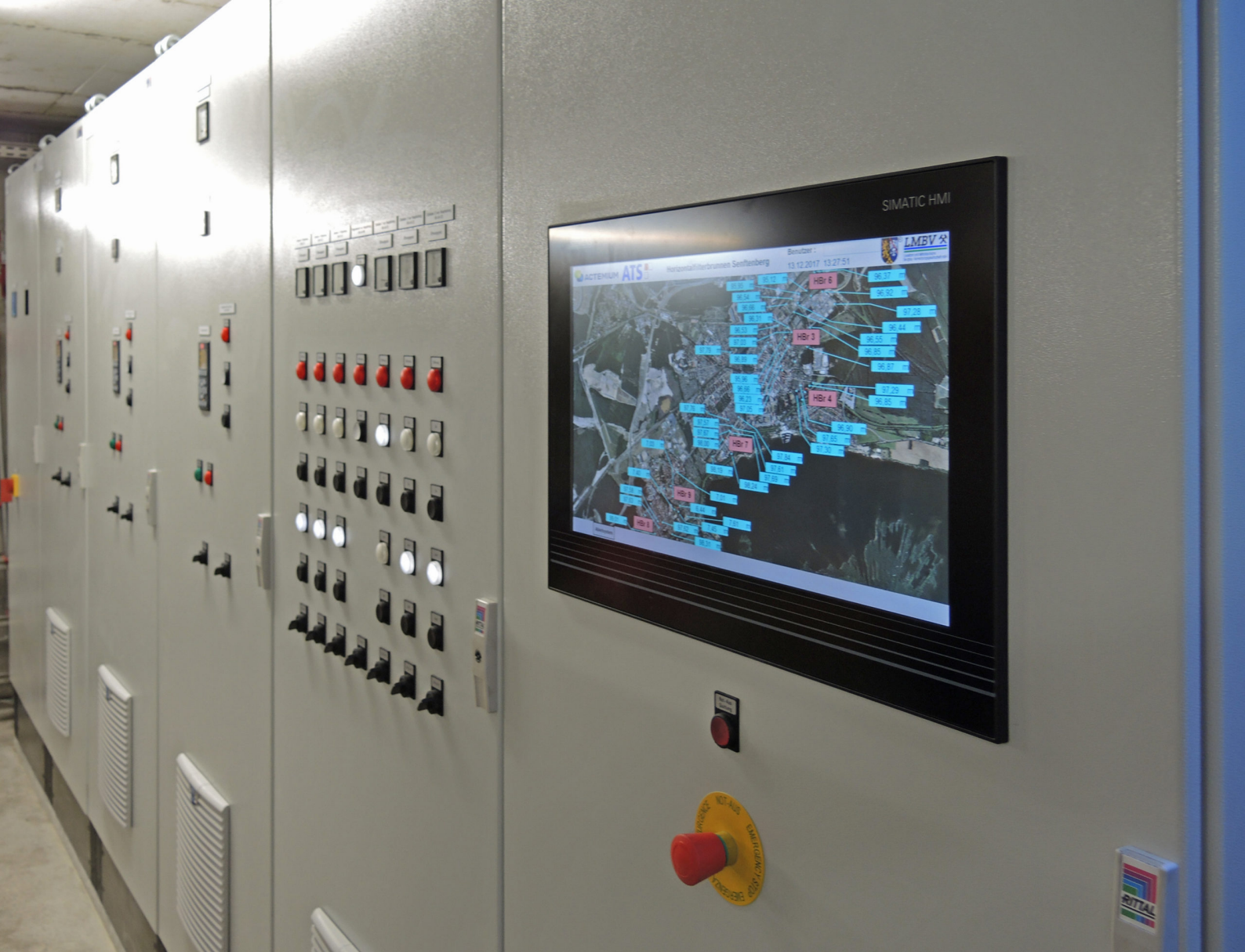
Brunnenstube: Steuerungseinheit des HBr 9 | Foto: S. Klein
