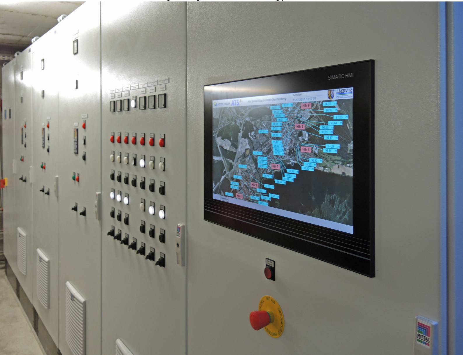
Brunnenstube: Steuerungseinheit des HBr 9 | Foto: S. Klein
