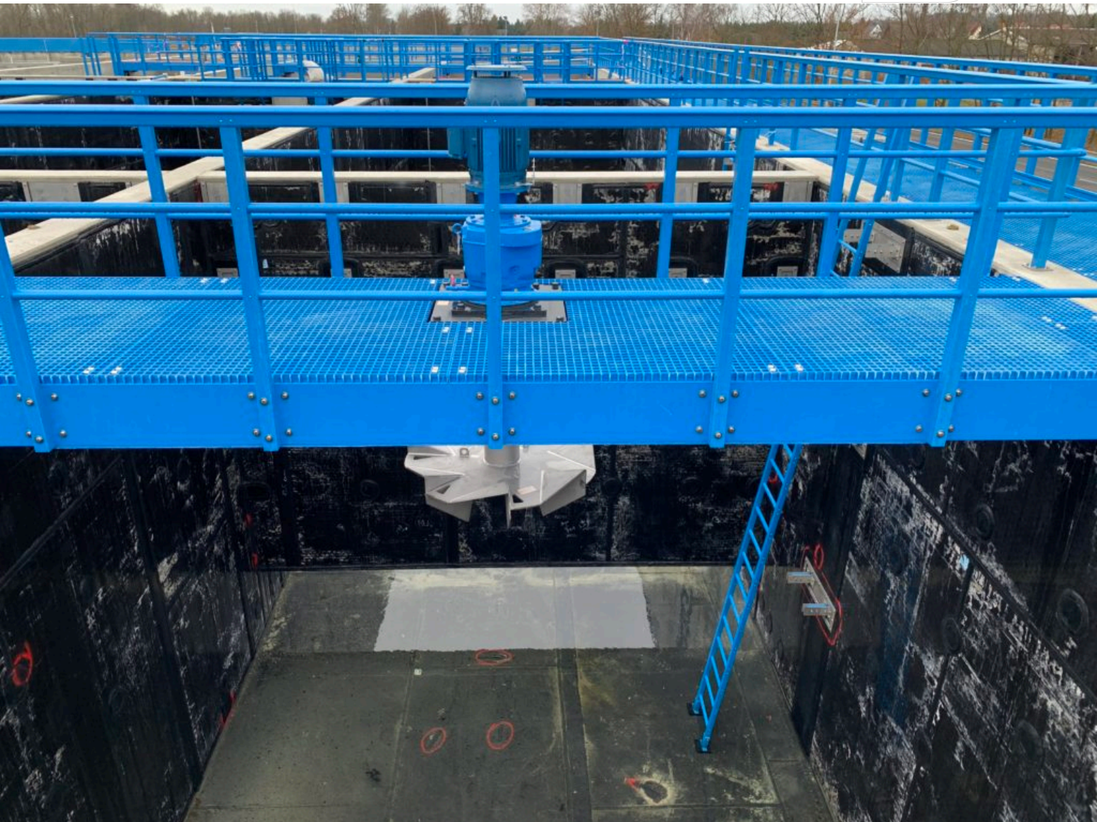
Rührwerk im Reaktionsbecken
