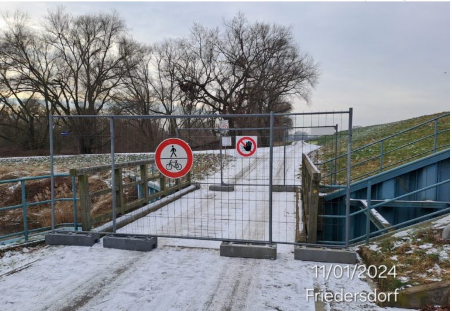
Nach der Bauwerksprüfung musste die Brücke am Wirtschaftsweg gesperrt werden. (Foto: LMBV, Januar 2024)
