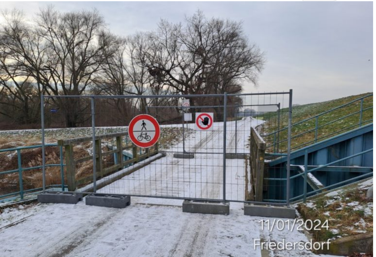
Nach der Bauwerksprüfung musste die Brücke am Wirtschaftsweg gesperrt werden. (Foto: LMBV, Januar 2024)
