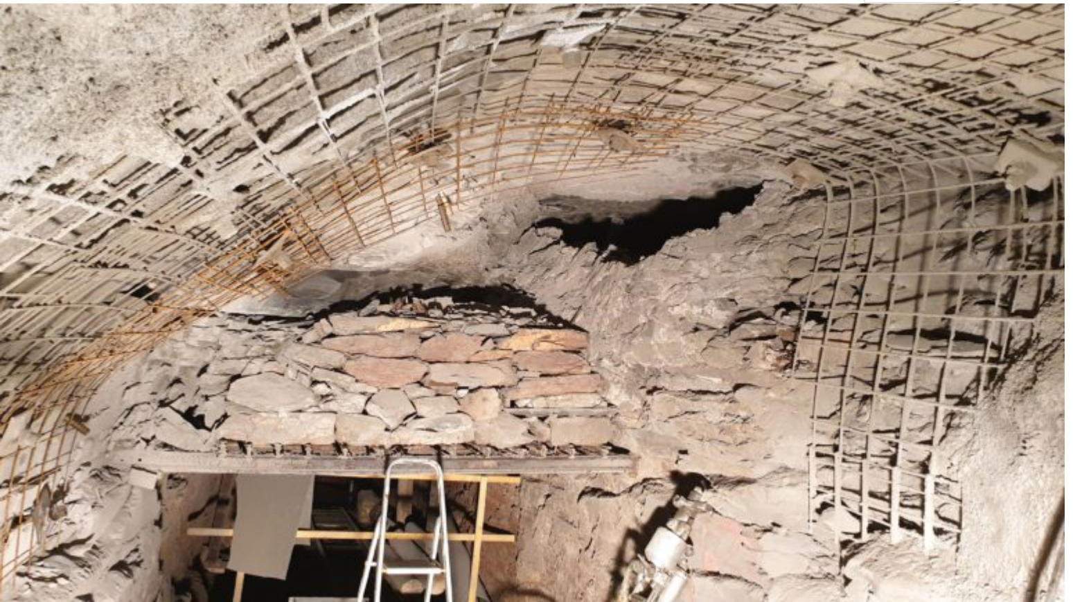
Sanierungsnotwendigkeit im Schlüsselstollen
