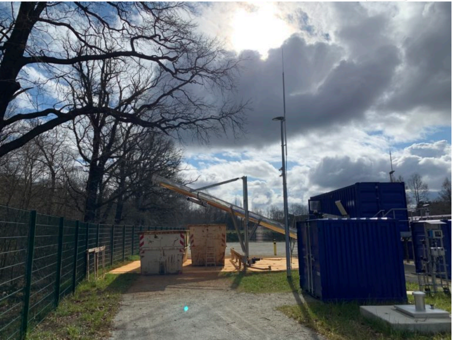
Der anfallende Eisenhydroxidschlamm wird in Containern aufgefangen und bspw. als Zuschlagstoff verwertet
