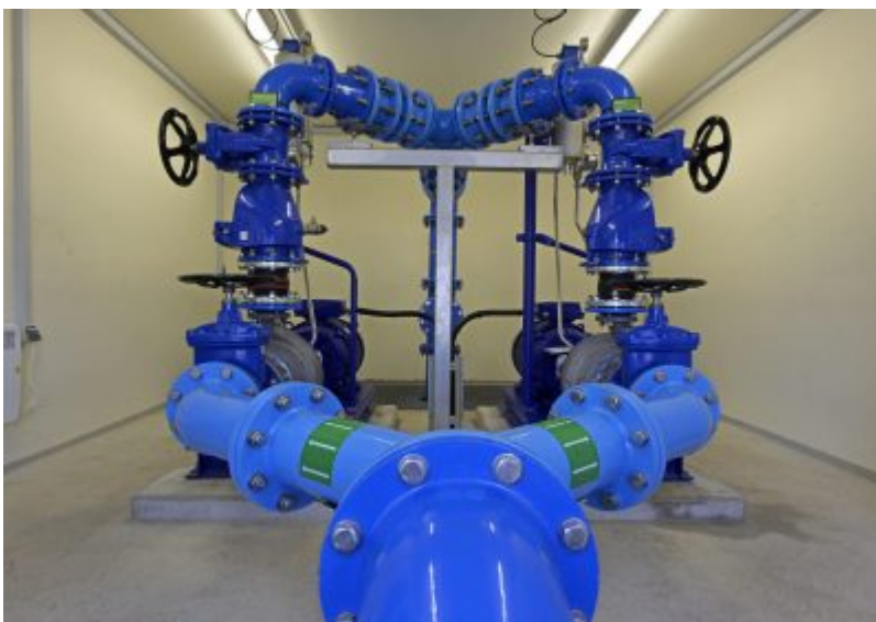
Pumpen der Laugenleitung in Menteroda
