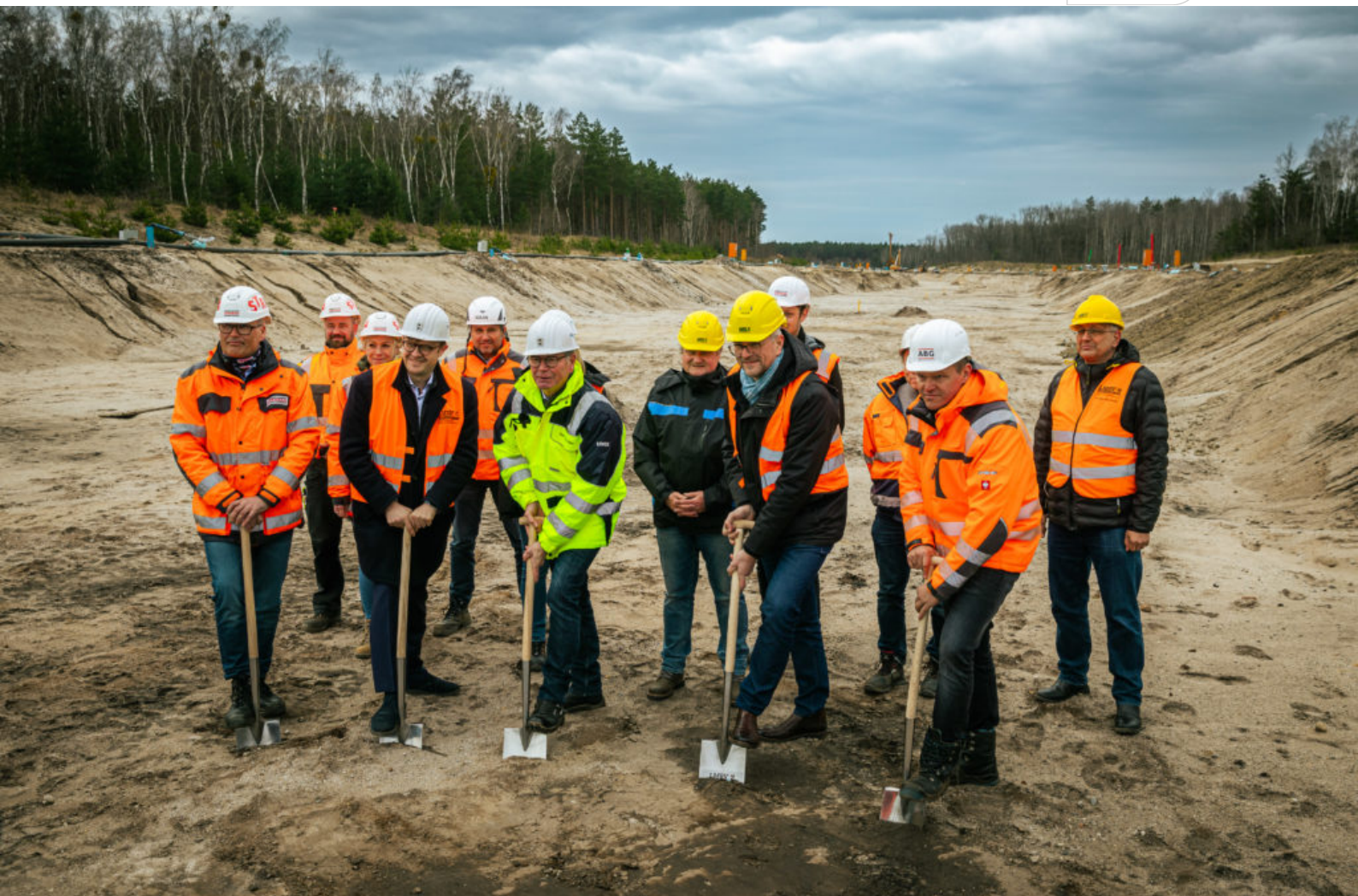
Offizieller Spatenstich (v.l.): Jörg Frisch (Technischer Bereichsleiter Strabag), Andreas Pfeiffer (Bürgermeister Senftenberg), Gerd Richter (Sanierungsbereichsleiter Lausitz LMBV), Daniel Just (Geschäftsführer ZVLSS) und Henry Kleinstück (Geschäftsführer ABG)
