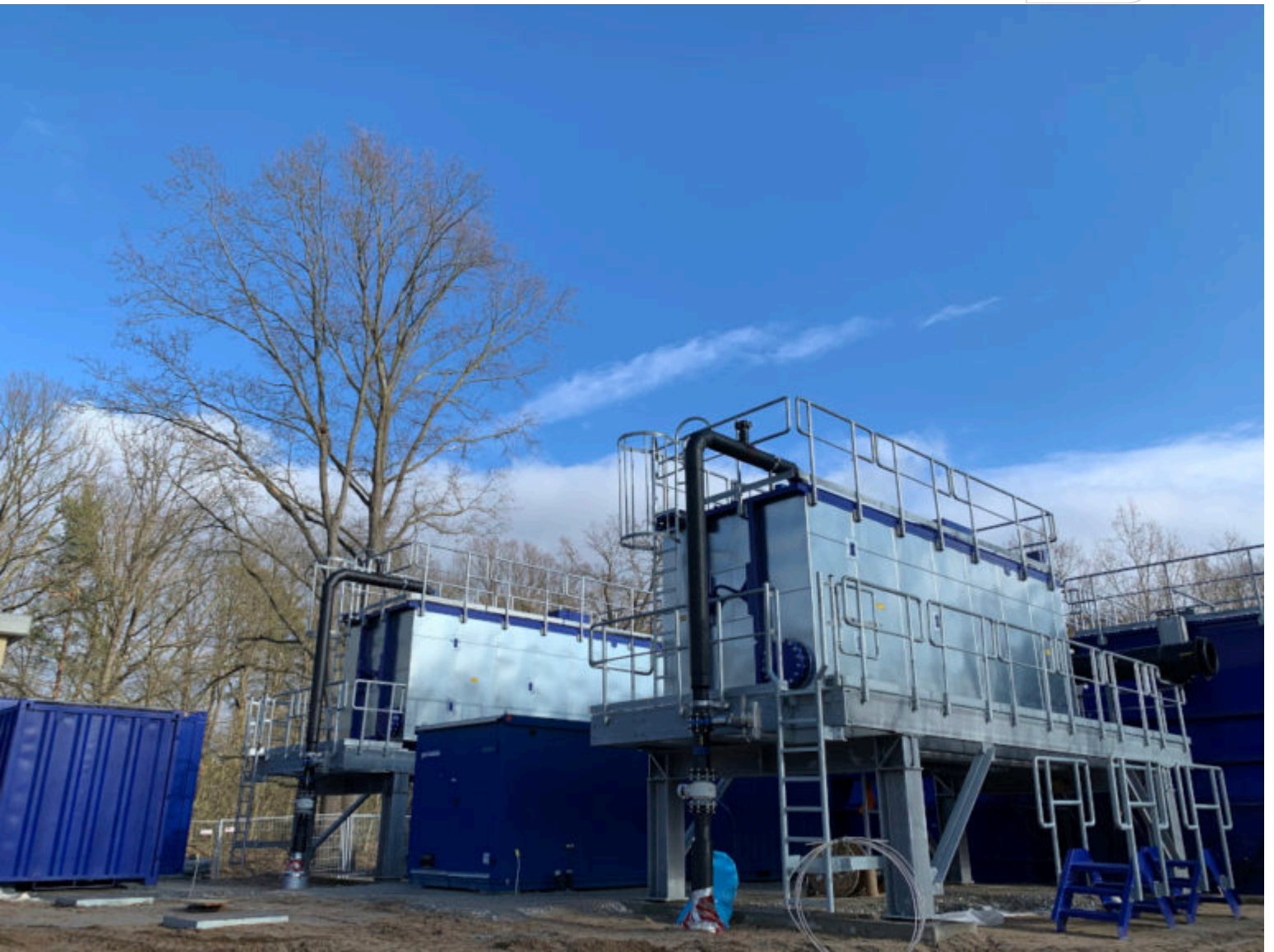
Flockungscontainer | MWBA Ruhlmühle
