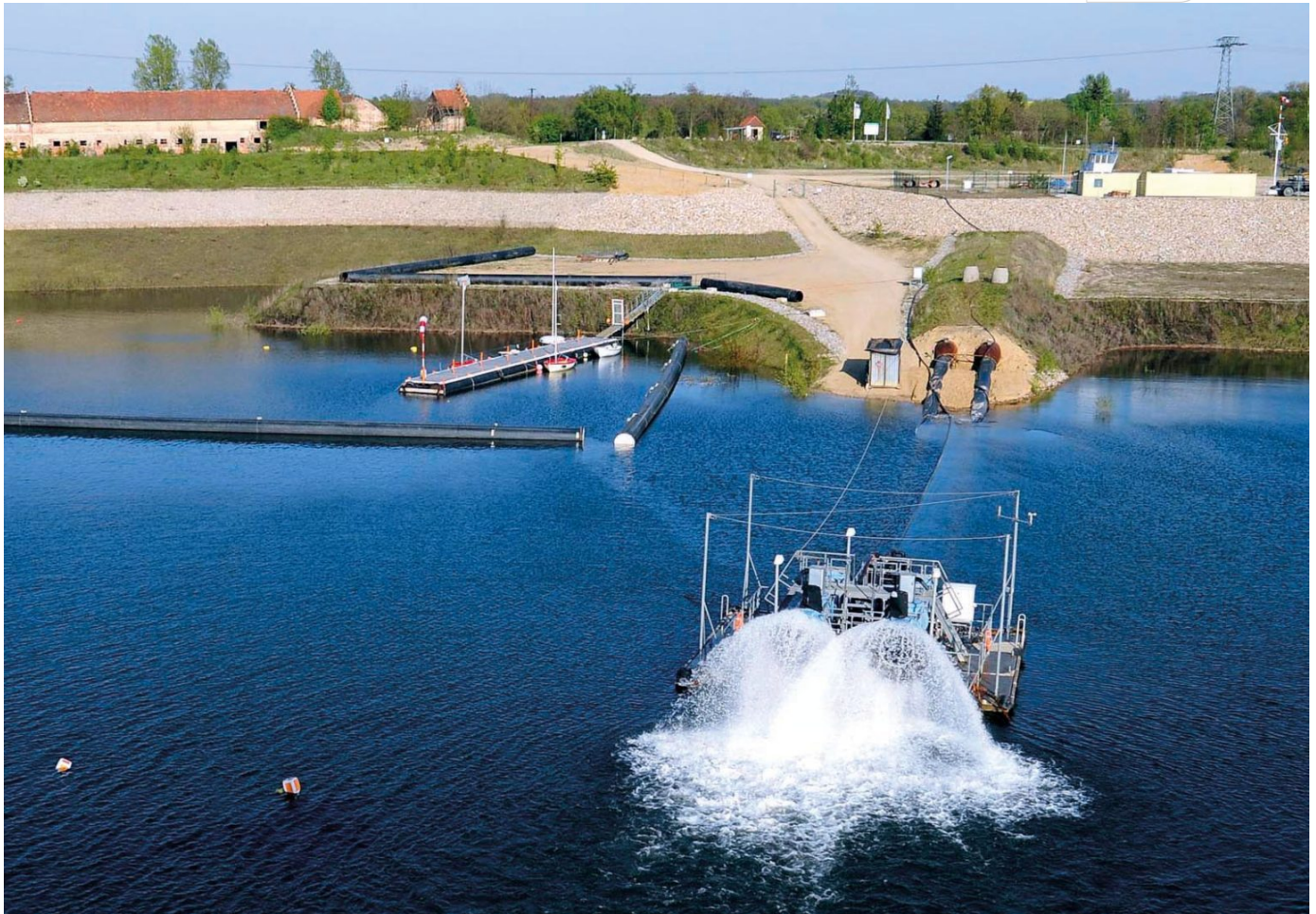
Flutungsleitung im Berzdorfer See
