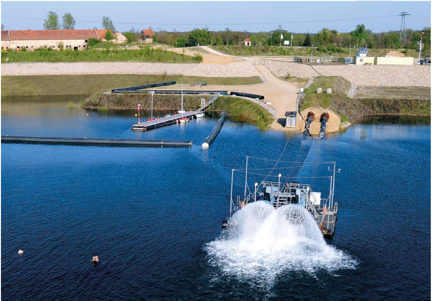
Flutungsleitung im Berzdorfer See
