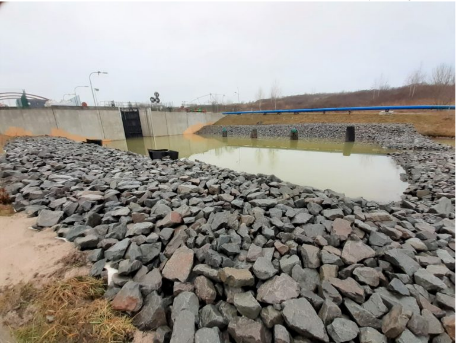
Neu gebauter Stützkörper aus Wasserbausteinen im Unterhafen des Störmthaler Kanals, Foto: LMBV/Falk Bräuer
